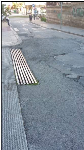
Figura 3: Rejillón en salida de cochera
