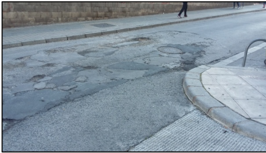
Figura 1: Estado actual de calle
