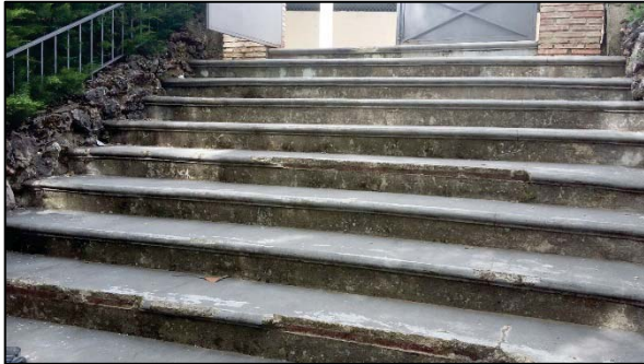
Figura 1: Estado de deterioro de la escalera
