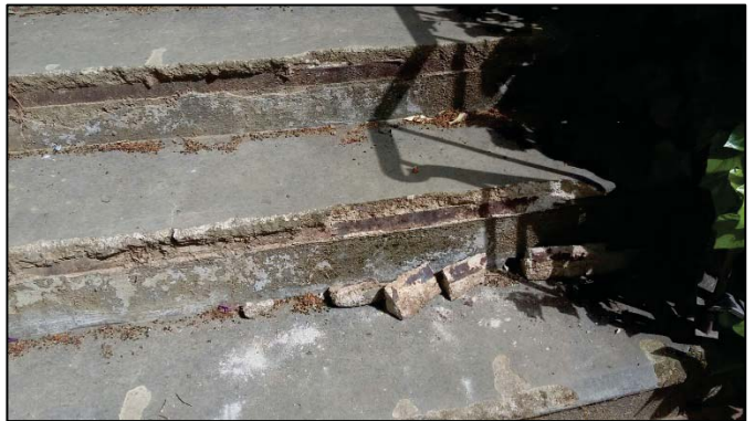
Figura 2: Estado actual escalones
