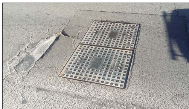
Figura 2: Arqueta de ENDESA en pavimento
