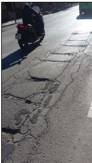
Figura 1: Estado actual de calle
