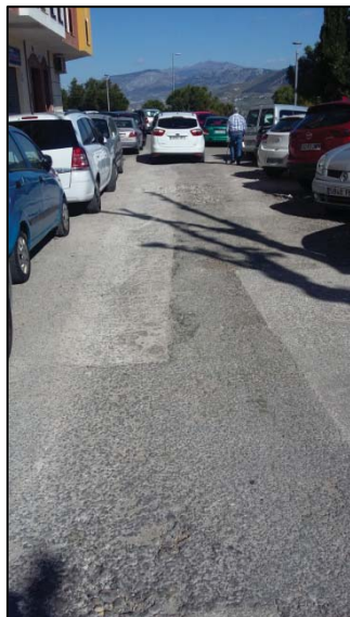
Figura 1: Estado actual de calle
