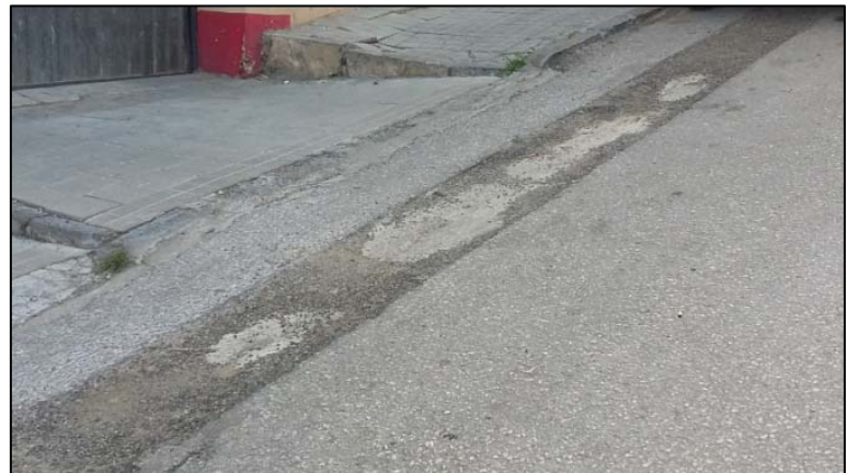
Figura 5: Indicios de reparaciones en canalizaciones
