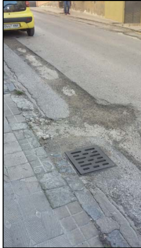
Figura 1: Estado actual de calle
