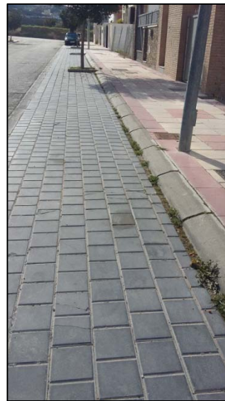
Figura 2: Bordillo próximo a farola
