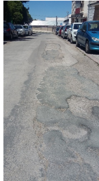
Figura 2: Hundimientos de pavimento
