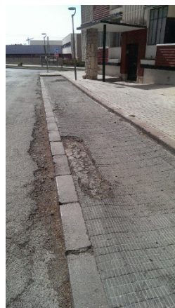
Figura 4: Hundimiento de aparcamiento
