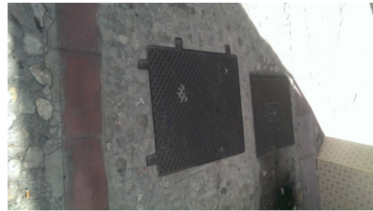
Figura 2: Arquetas de telecomunicaciones
