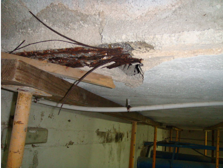
Detalle del estado de una de las viguetas del forjado actual. Existen otras más en estado semejante.
