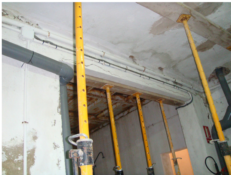
Dintel de la zona de acceso, tambien a reforzar.
