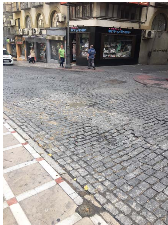
Figura 2: Hundimiento en calle Ramón y Cajal
