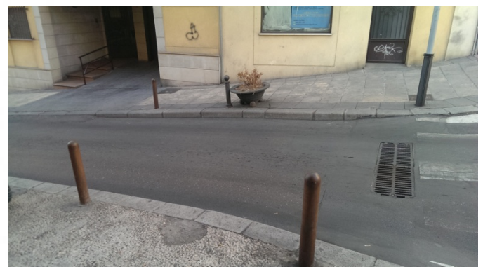
Figura 4: Imbornal afectado por las obras
