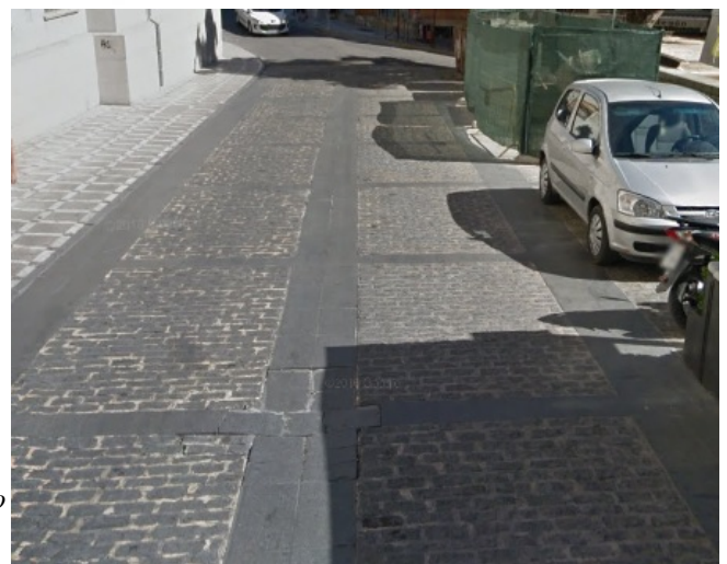
Figura 4: Estado actual de la calle Joaquín Tenorio
