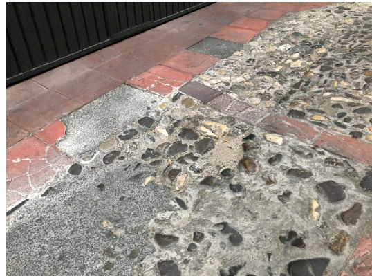
Figura 2: Hundimientos de pavimento
