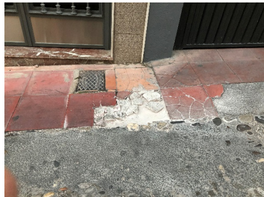
Figura 6: Hundimiento de solería
