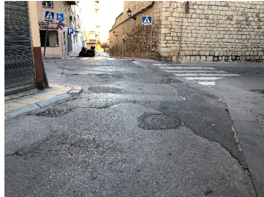
Figura 2: Hundimientos de pavimento
