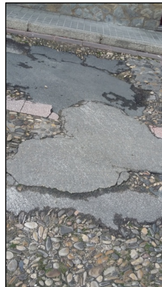
Figura 4: Hundimientos de pavimento detectados.
